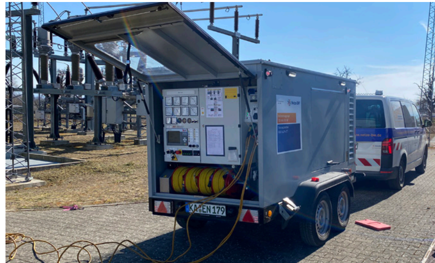
100 kVA Notstromaggregat für die schnelle Wiederversorgung bei Störungen mit Stromausfall im Niederspannungsnetz.
