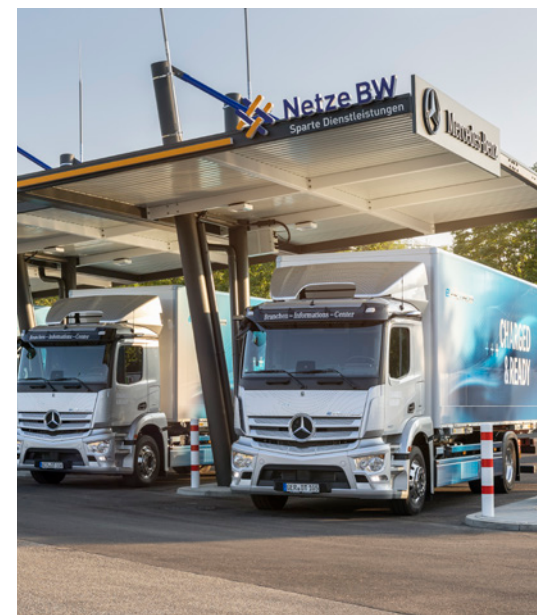
Im eTruck Charging Park stehen derzeit mehrere Ladesysteme mit Leistungen zwischen 40 und 300 kW zur Verfügung.
