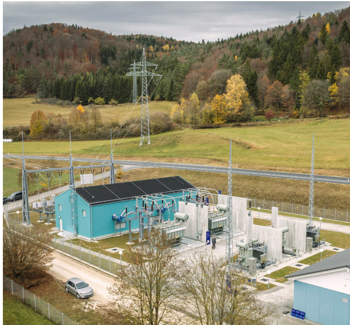
Das Umspannwerk in Burladingen wurde im November 2023 eröffnet. Es handelt sich hierbei um das erste Umspannwerk weltweit, das Digitalisierung und Ökoeffizienz in diesem Umfang anbietet.
