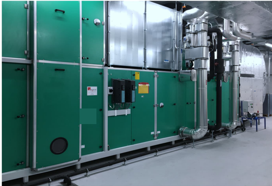
Fig. 6-2 Luftaufbereitungsgerät in einer Technikzentrale (Quelle: Siemens)
