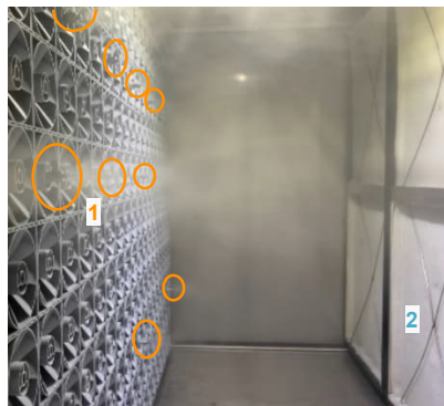
Befeuchter in Aktion (Sicht durch Schauglas) mit Sprühdüsen vor Turbulatoren (1) und Tropfenabscheider-Matte (2) rechts
