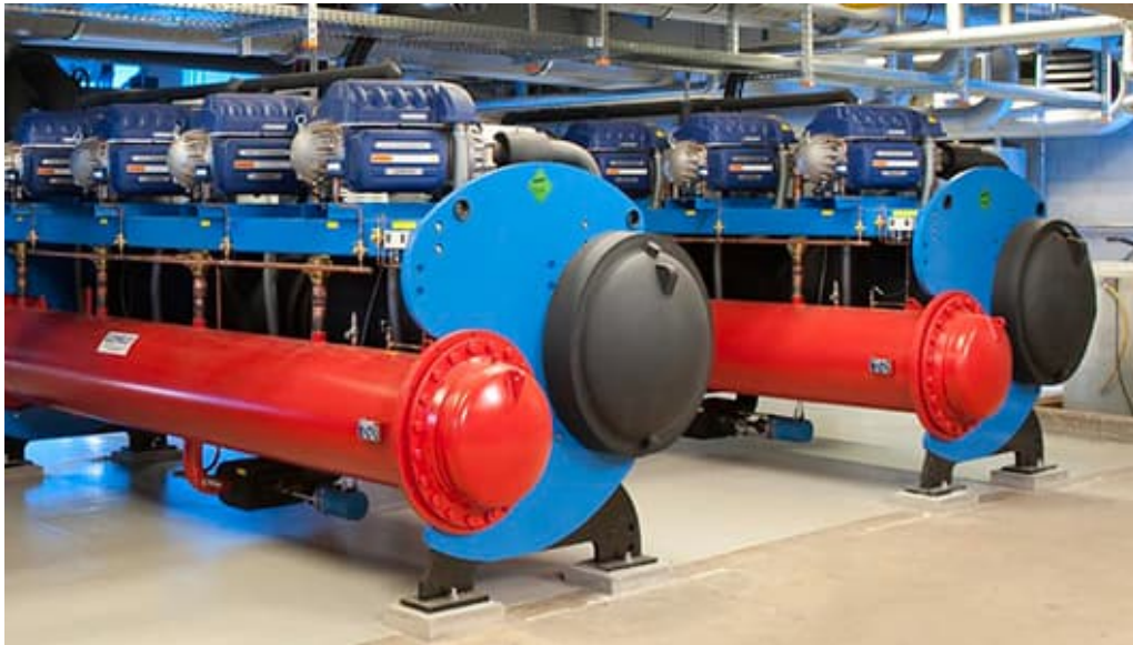
Fig. 4-1 Kaltwasser-Kältemaschinen-Anlage mit ölfreien Turbocor®-Verdichtern (Quelle: engie-refrigeration)
