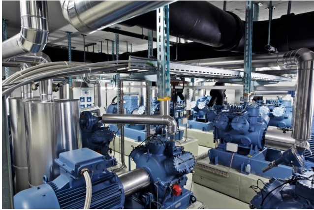
Fig. 3-40 Großwärmepumpen (Ammoniak, \text{NH}_3 ) liefern Wärme in einer Fernwärme-Heizzentrale (Quelle: EWZ)
