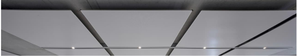
Fig. 3-78 Deckensegel mit integrierten Leuchten (Quelle: Barcol-Air)
