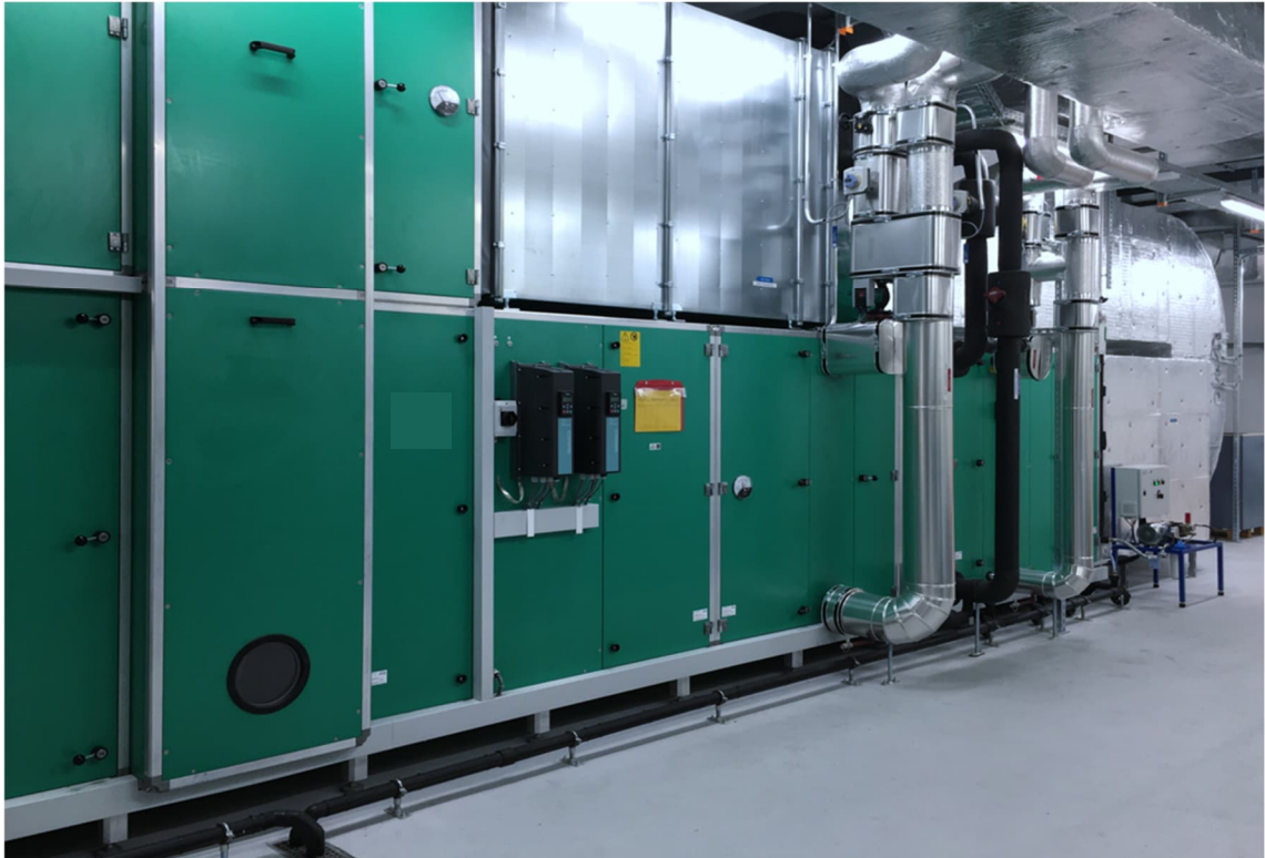
Fig. 6-1 Luftaufbereitungsgerät in einer Technikzentrale (Quelle: Siemens)
