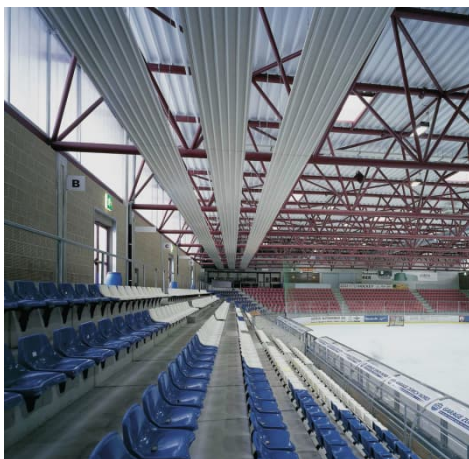
Fig. 3-79 Deckenstrahlplatten in Eishockeystadion (Quelle: Zehnder-Systems)
