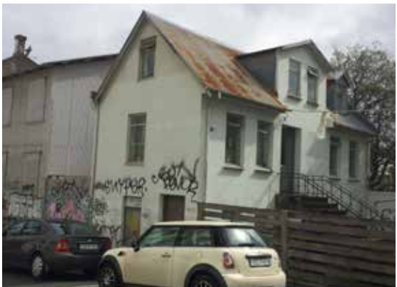
Vatnsstígur 4 og Laugavegur 33a eru aldursfriðuð hús sem til stendur að rífa. Húsin eru illa farin af vanrækslu en vel viðgerðarhæf
