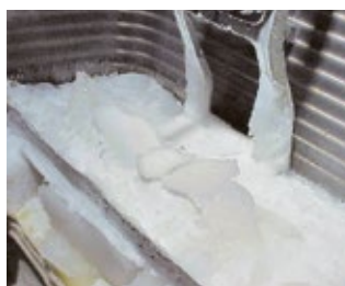
Formation de glace sur l'unité extérieure sans chauffage de la cuve
