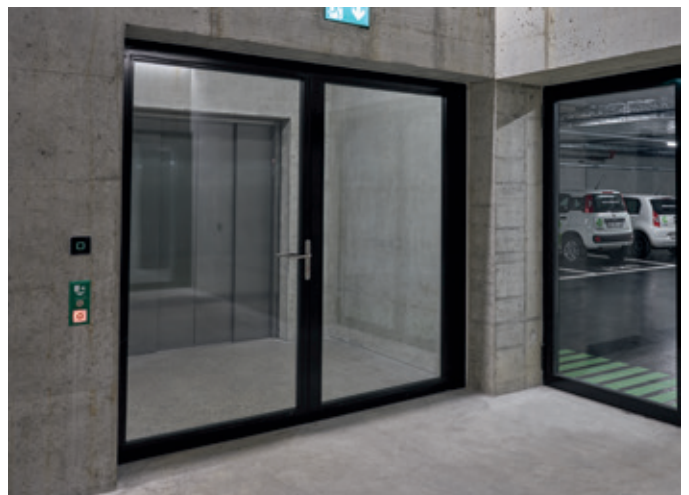
SafeRoute-System und Leser für Garagenzugänge
