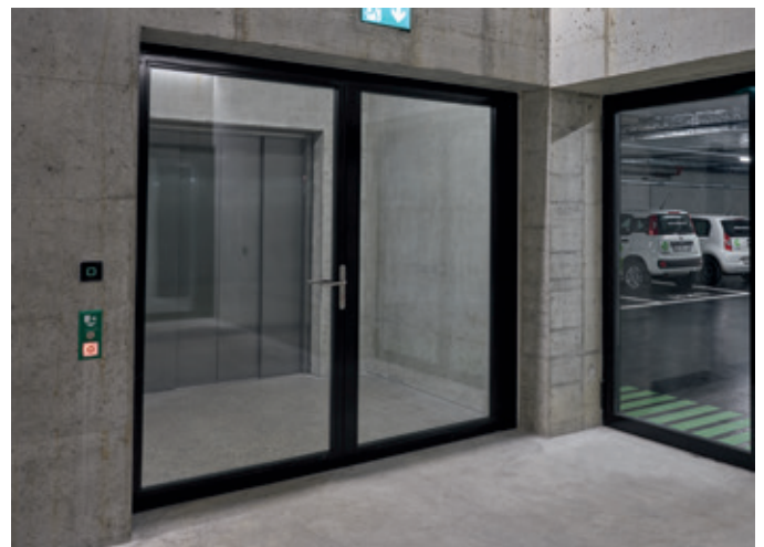
SafeRoute-System und Leser für Garagenzugänge
