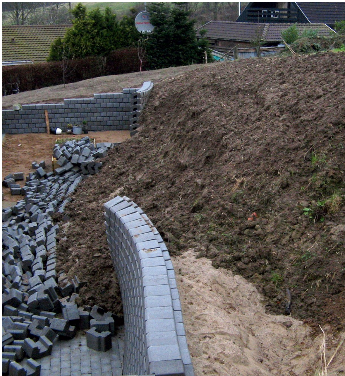
Eksempel på kollapsedet mur. Muren er kollapsedet, fordi der ikke i opbygningen er taget hensyn til den forøgede jordlast fra skråningen bag muren.
