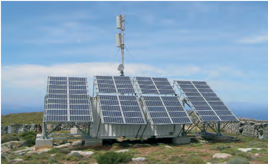
Φωτοβολταϊκό σύστημα σε Σταθμό Βάσης
