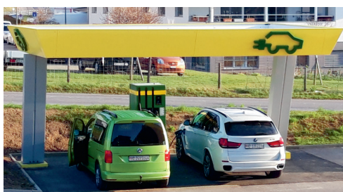
La nouvelle station de recharge est opérationnelle
