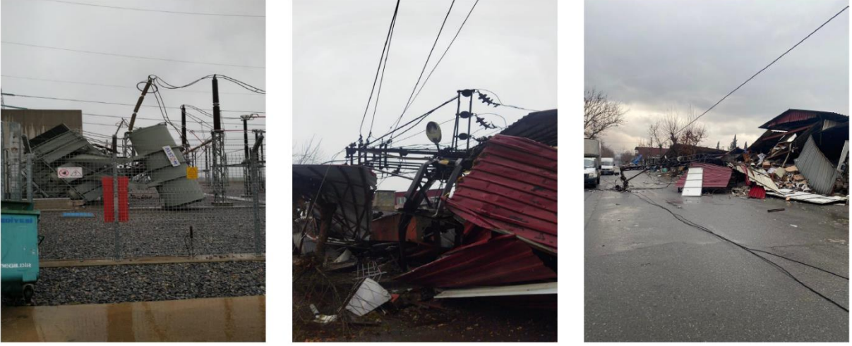
Resim 1.14. Trafo ve Enerji Nakil Hattı Hasarları
