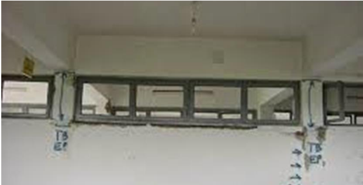
Resim 3.17. Kısa Kolon Hasarı (Sağdaki)
