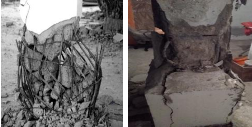
Resim 4.45. Yetersiz Sargılama, Korozyon, Donatı Burkulması 537
