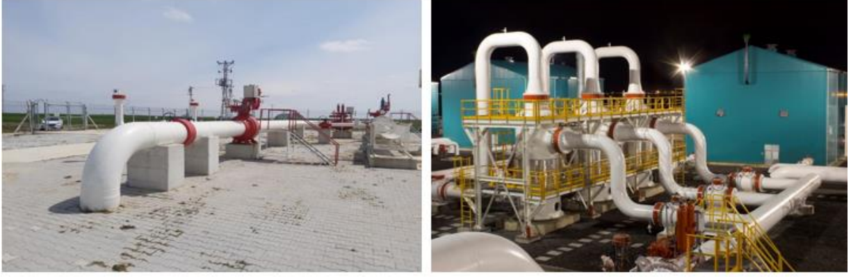
Resim 1.16. BOTAS İletim Hatları Yerüstü Tesisleri
