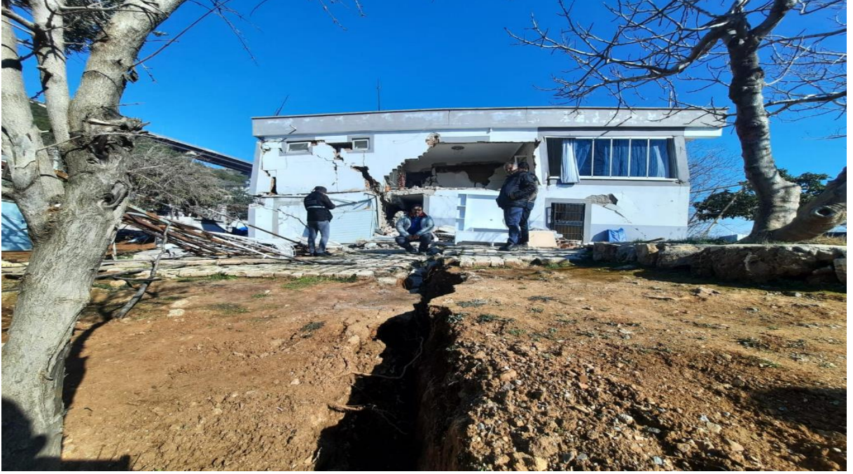
Resim 3.14. Fay Hattı Üzerinde Hasar Görmüş Bir Köy Evi
