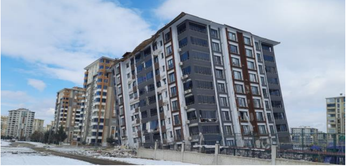
Resim 3.26. Kahramanmaraş Merkezli Deprem Bölgesinde Sıvılaşma Sonucu Yan Yatarak Zemine Batmış Bir Binanın Görünüşü
