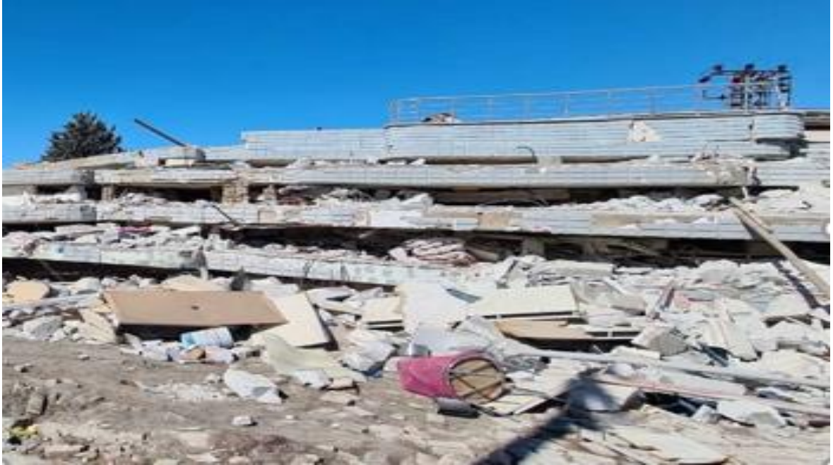
Resim 3.15. Toptan Göçme Şeklinde Yıkılan Bir Binanın Görünüşü (Gölbaşı/Adıyaman)
