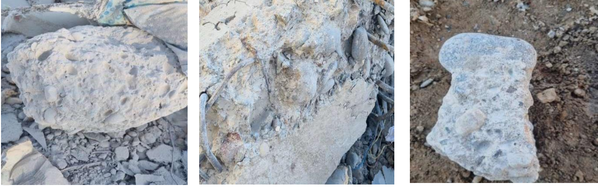
Resim 3.20. Kahramanmaraş'ta Toptan Göçen Binalardan Kopan Beton Parçaları
