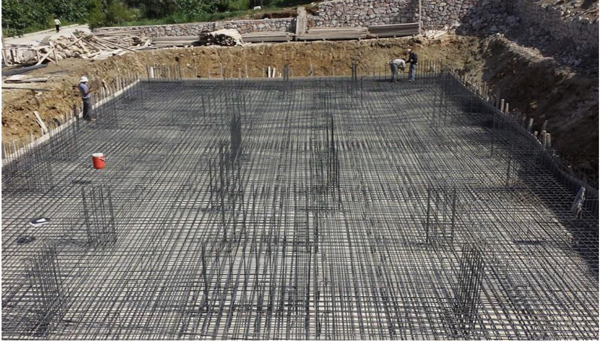
Resim 3.28. Beton Döküm Aşamasından Önce Donatısı Döşenmiş Bir Radye Temel Kaynak: Google Earth.
