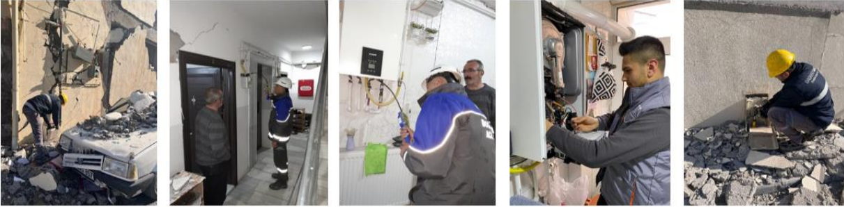
Resim 1.20. Doğal Gaz Dağıtım Şebekesi Hasarları
