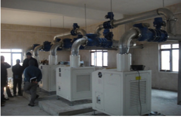
Şekil 7.23. Havalandırma Havuzu Blowerları
