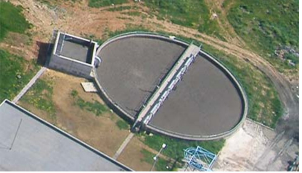
Şekil 7.29. Çamur Depolama Havuzu
