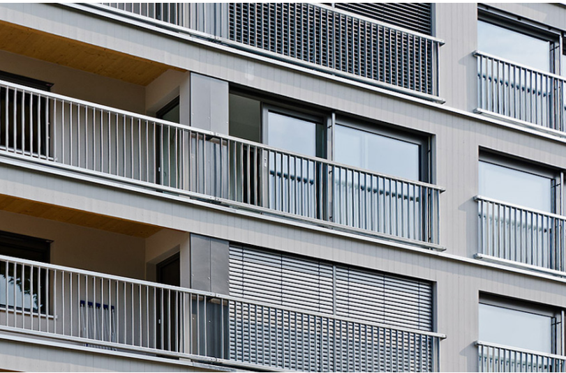
Abb. 54: In die Fassaden integrierte Raffstorekästen
