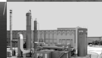
Captage et liquéfaction du CO 2 CO 2 capture and liquefaction
