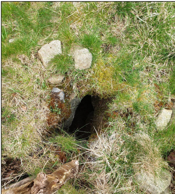
Figur 33: Vekstmasser ble her lagt rett på grov sprengstein uten at fyllingen først ble mettet med finere masser. Når vekstmassene gradvis vaskes ned i fyllingen oppstår det, ofte etter flere år, hull i vegetasjonsdekket. Hullene kan være til fare for mennesker og dyr som ferdes i området.
