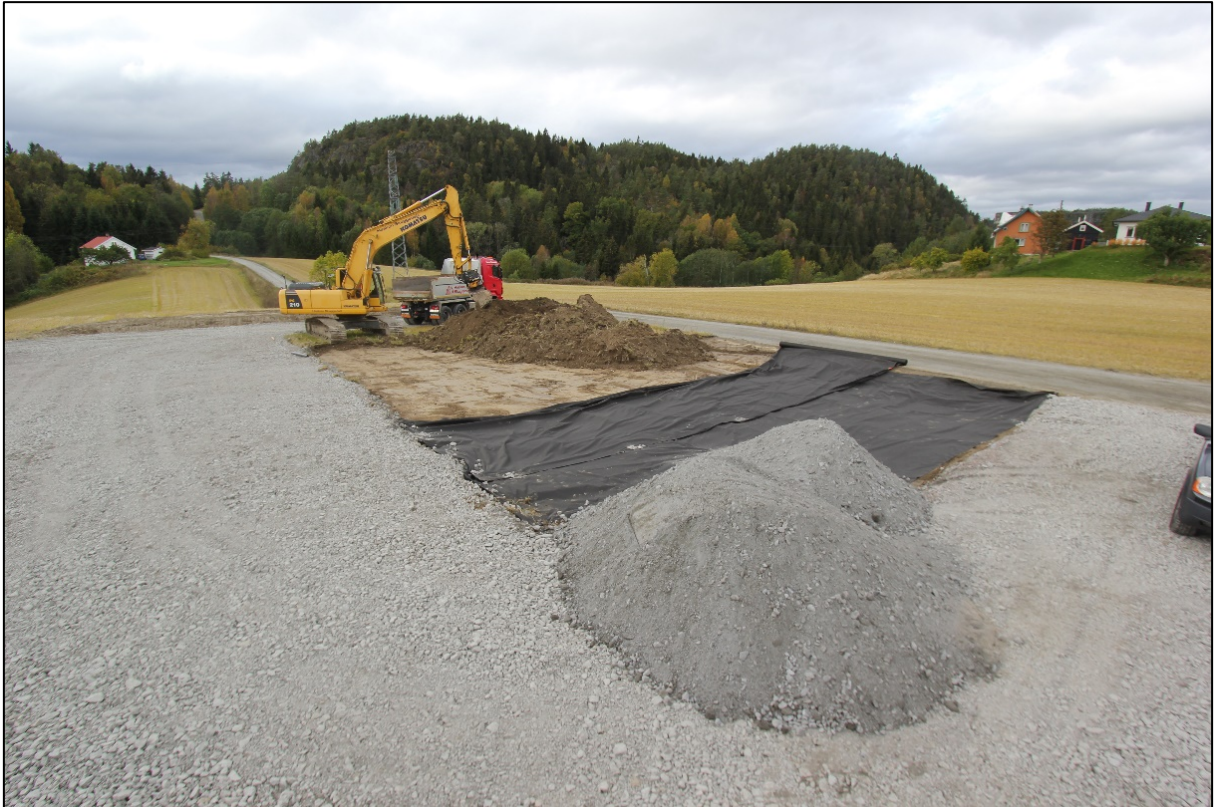
Figur 15: Riggområde på dyrka mark. Matjorda skaves av før et bærelag av grus legges på duk. Foto: Norconsult AS.
