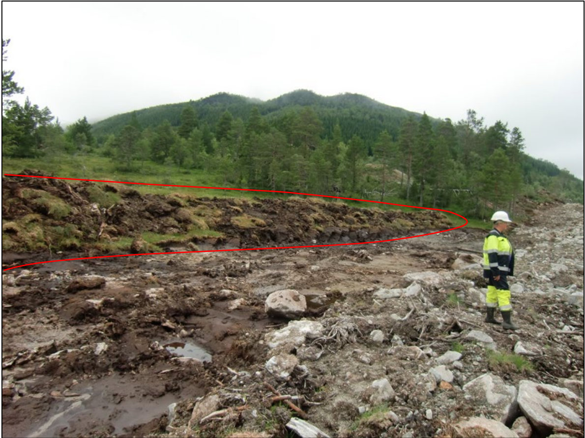
Figur 18: I områder der det ikke skal sprenges, kan massene lagres langs eller i nærheten av inngrepet. Toppmassene (vekstjord) legges i ranker adskilt fra undergrunnsmassene. Ved å lagre vekstjorda nært inngrepet som her, er massene lett tilgjengelige for bruk når området skal istandsettes.
