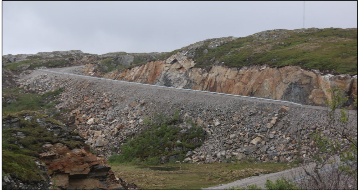
Figur 30: Sprengsteinsfylling med et uryddig preg. Den grove sprengsteinen danner store hull, og fuktighet dreneres vekk. Metning av fyllingen med finere masser ville dempet det uryddige preget og bidratt til å holde bedre på fuktighet som er en forutsetning for vegetasjonsetablering. På sikt ville da spredt vegetasjon kunne brutt opp den store fyllingsflaten. Se også neste bilde.
