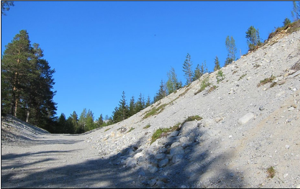
Figur 60: Erosjonsutsatt løsmasseskjæring der geonett eller kokosmatter ville kunnet bidra til å stabilisere massene. I dette tilfellet i kombinasjon med påføring av vekstmasser.
