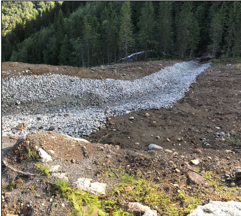
Figur 61: Sikker håndtering av overflatevann i bratt terreng. Grøfta er lagt med begrenset helning og steinsatt slik at vannhastigheten reduseres. Stein størrelsen kunne i dette tilfellet vært mer variert og vekstmassene kunne vært trukket mer inn over steinmassene for å gjøre grøfta mindre synlig, og for å få en mer naturlig overgang mellom grøft og tiliggende terreng.
