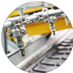
Sistema de extinción de incendios
