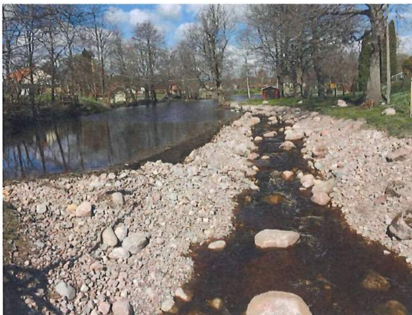
Figur 1. Inlöpet vid Nävekvärn i Sörmland. En motsvarande lösning är möjlig vid Hornsjöns utlopp. Vid höga flöden rinner vatten över hela betongväggen/överfallsdammen som då fungerar som breddtröskel. Om dammluckor ändå skulle anses nödvändiga trots en lång (cirka 20 meter eller mer) breddtröskel så skulle dessa i fotot ovan vara placerade till vänster i bild. OBS. Fotot är spegelvänt. Foto: Nils Ljunggren/Sportfiskarna.
