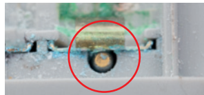
Un connettore principale della batteria contaminato
