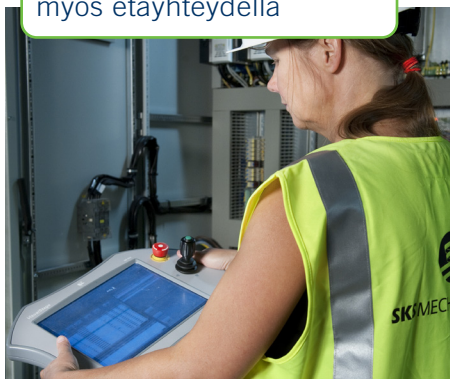
Huolto- ja kunnossapito myös etäyhteydellä
