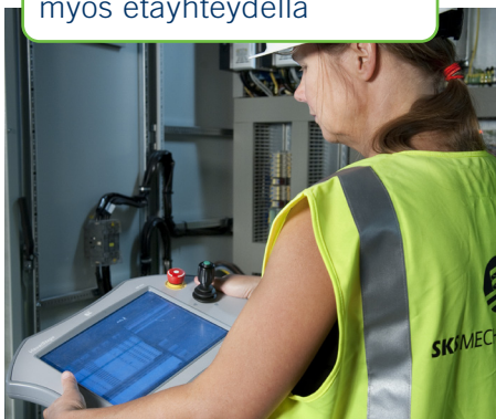
Huolto- ja kunnossapito myös etäyhteydellä
