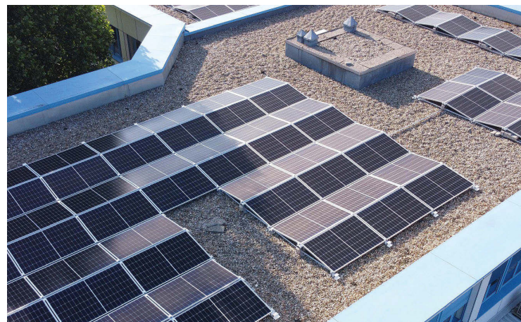
Photovoltaikanlage Attensam Zentrale
