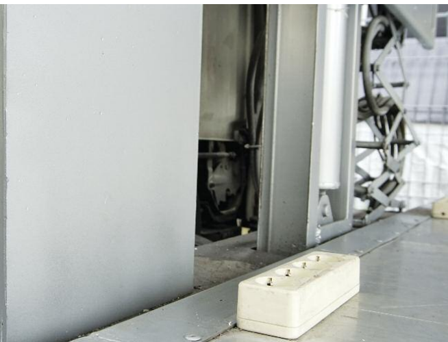
Terminal listrik AC
