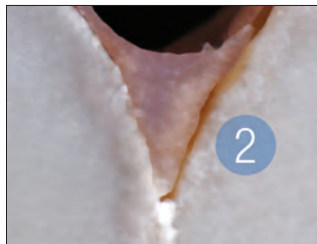
Отслаивание от краёв.
