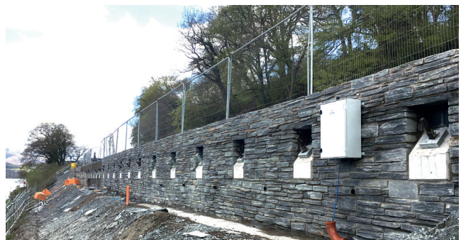
ÜBERWACHUNG MITTELS SMART ANCHOR
