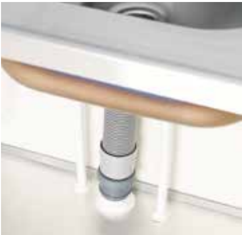
Tetningssett rundt rør i vaskeskap
